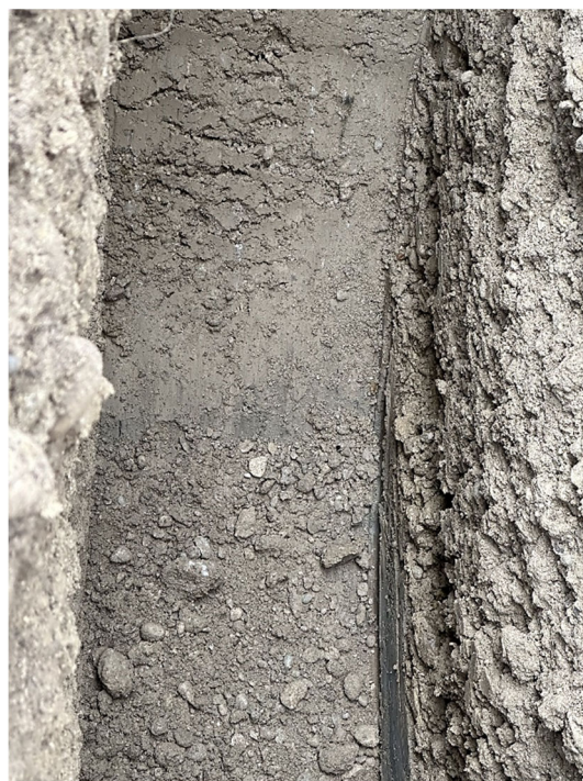
Abbildung 2: Detailansicht Sohle P1 (ab -2.8 m OKT)
