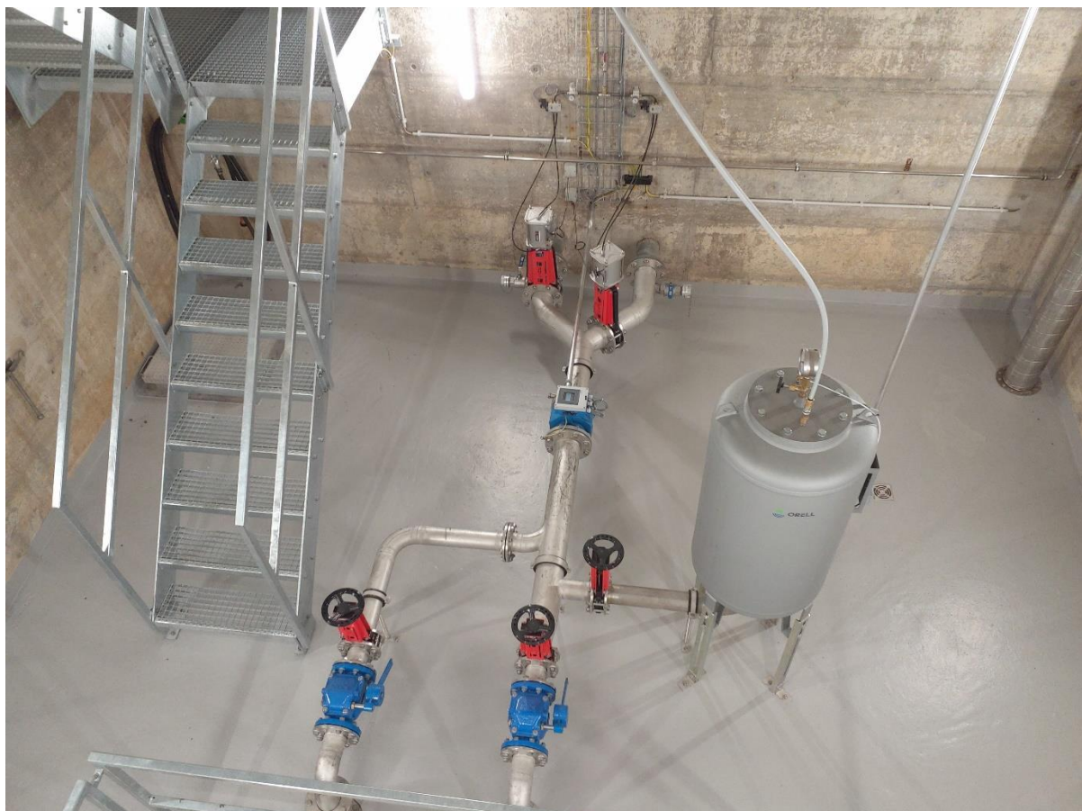
Rohrkeller: links neuer Treppenabgang, rechts Druckschlagdämpfer
